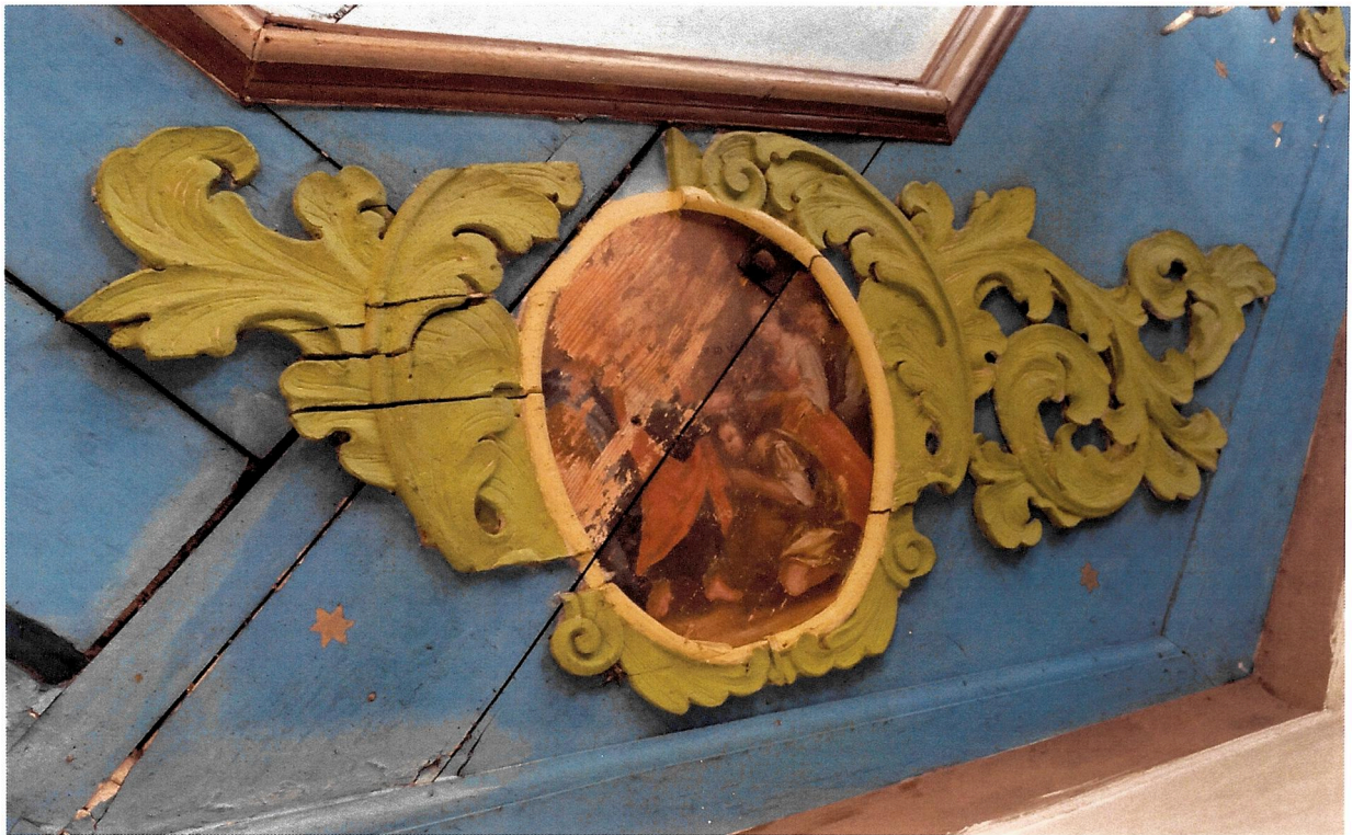
fot. 9 Kościół pw. Chrystusa Króla w Dłużycach, strop prezbiterium (II poł. XVII w.). Scena chrztu strażnika więziennego. Widoczne ubytki warstwy malarskiej, elementów snycerki i półwałków ramy; późniejsza polichromia deskowania i snycerki. Stan przed konserwacją. Fot. G. Wątor, 2021.
