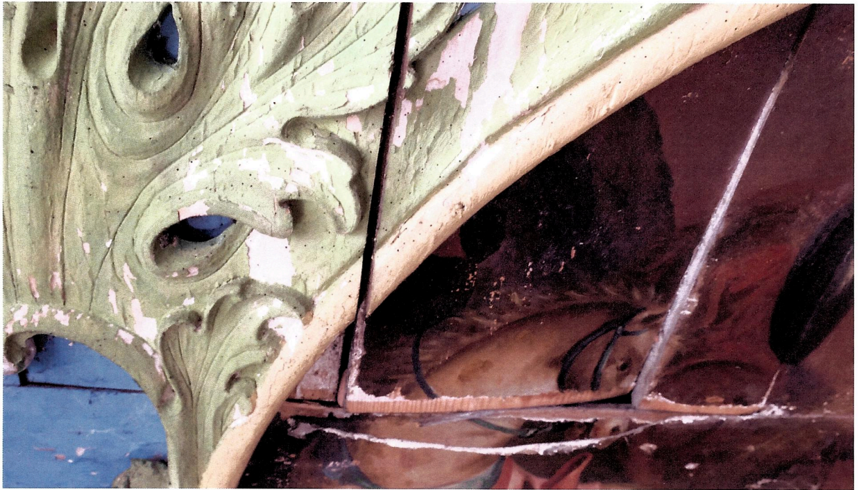
fol. 24 Kościół pw. Chrystusa Króla w Dłużycach, strop nawy (II poł. XVII w.). Polichromia stropu, zbliżenie. Widoczne szczątki starszych warstw malarskich i zaprawy pod współczesną polichromią; ubytki i łuszczenie się polichromii. Stan przed konserwacją. Fot. G. Wątor, 2021.
