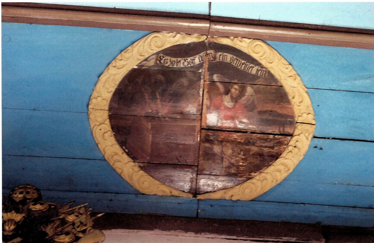
fot. 18 Kościół pw. Chrystusa Króla w Dłużycach, strop nawy (II poł. XVII w.). Emblemat z aniołem przy ołtarzu. Stan przed konserwacją. Fot. G. Wątor, 2021.
