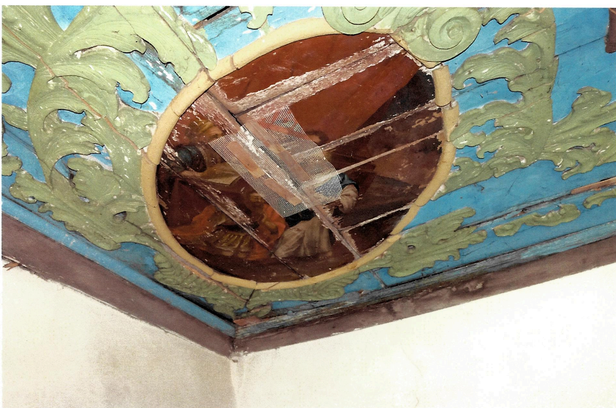
fot. 15 Kościół pw. Chrystusa Króla w Dłużycach, strop nawy (II poł. XVII w.). Scena chrztu Korneliusza. Widoczne rozległe ubytki i łuszczenie się warstwy malarskiej, brak pasów płótna; zawilgocenia; prowizoryczne zabezpieczenie z siatki. Stan przed konserwacją. Fot. G. Wątor, 2021.
