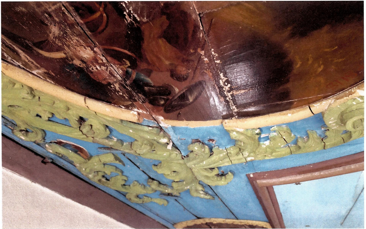
fot. 22 Kościół pw. Chrystusa Króla w Dłużycach, strop nawy (II poł. XVII w.). Stan zachowania polichromii i elementów snycerki, zbliżenie. Stan przed konserwacją. Fot. G. Wątor, 2021.
