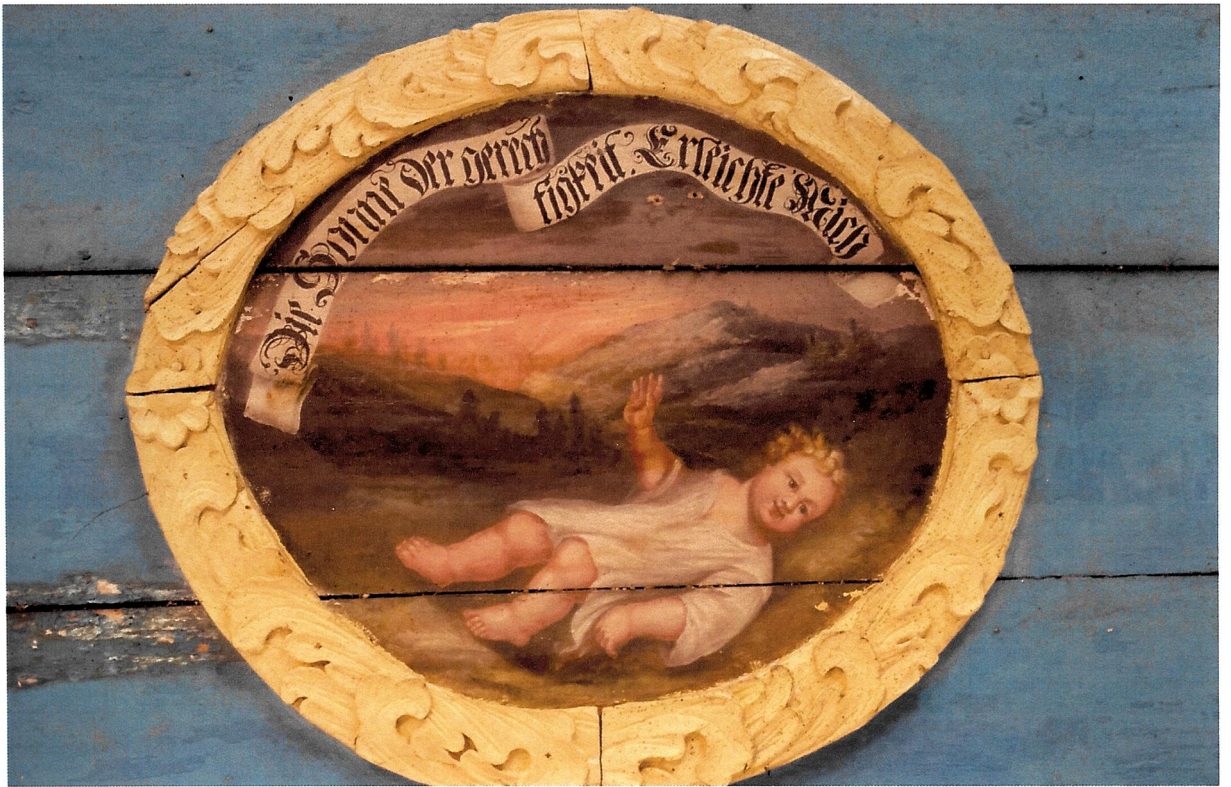
fot. 7 Kościół pw. Chrystusa Króla w Dłużycach, strop prezbiterium (II poł. XVII w.). Emblemat z leżącym dzieckiem w białej koszulce. Widoczne szczeliny w deskowaniu, ubytki polichromii, otwory po drewnojadach. Stan przed konserwacją. Fot. G. Wątor, 2021.
