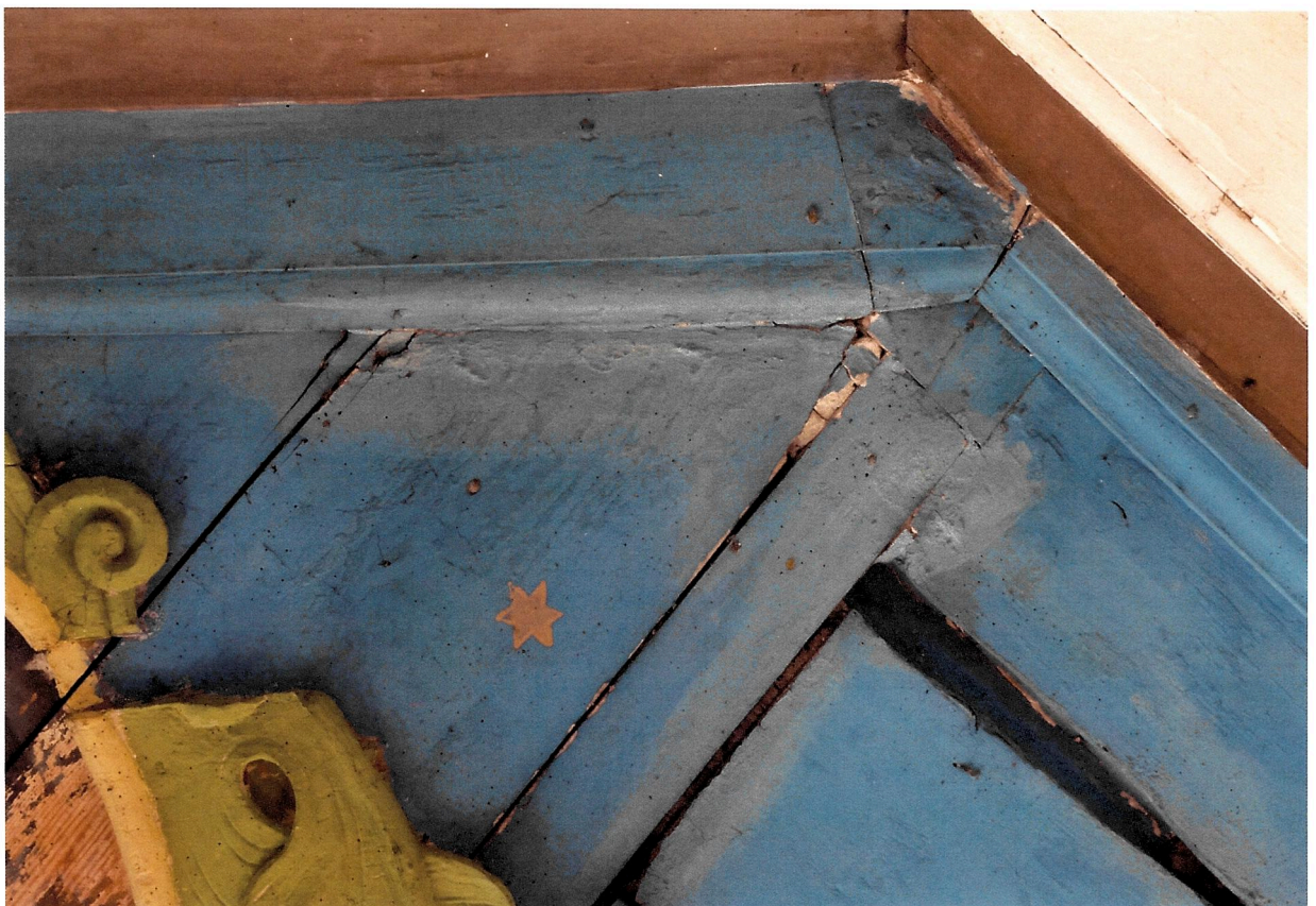
fol. 25 Kościół pw. Chrystusa Króla w Dłużycach, strop nawy (II poł. XVII w.). Deskowanie, zbliżenie. Widoczne szczątki starszych warstw malarskich i zaprawy pod współczesną polichromią. Stan przed konserwacją. Fot. G. Wątor, 2021.
